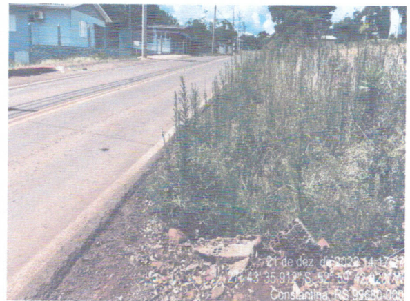
Necessidade de drenagem e pavimentação
